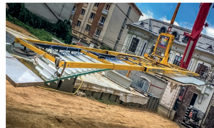
Instalația Heavydrive transportă sticla turnată în formă ondulată de 12,5 metri înălțime. Drepturi de autor imagine: montec-gmbh.de
